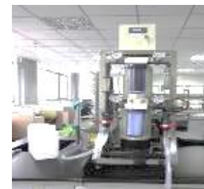
純水製造装置
